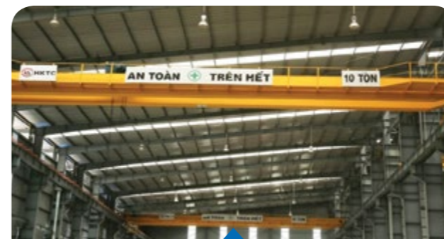
Crane 10 Ton (24 units)
